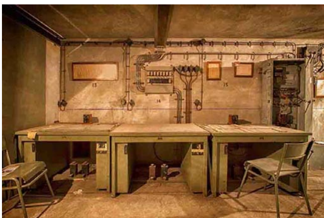
Poste de commandement
